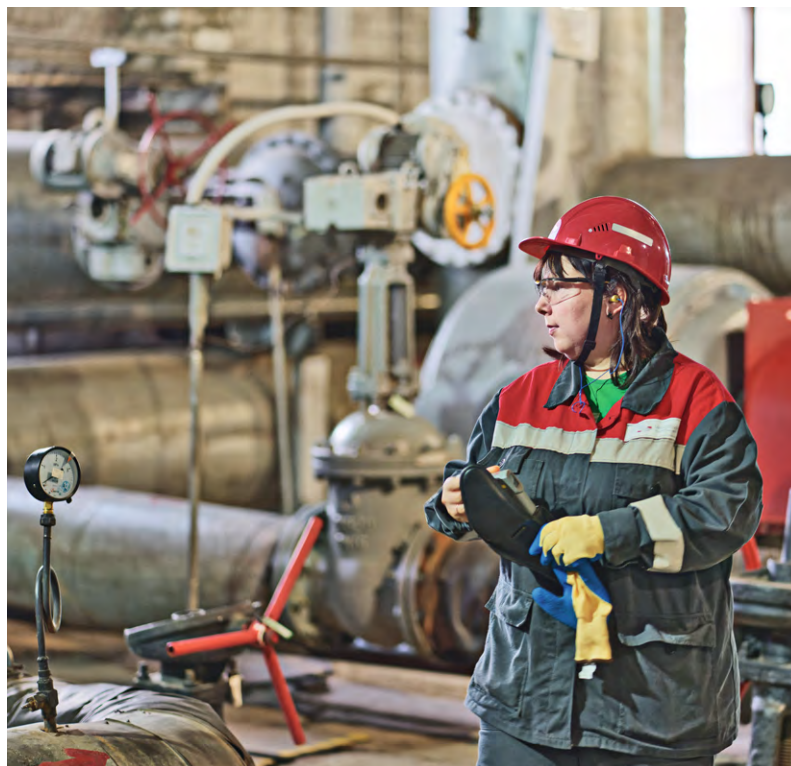
▲ Сотрудники теплосилового цеха непрерывно следят за работой оборудования
