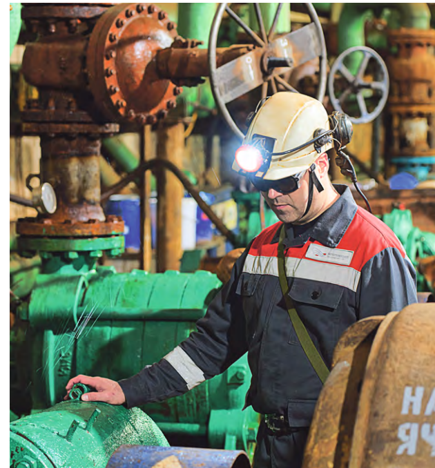
▲ Мощные насосы обеспечивают бесперебойное водоотведение
