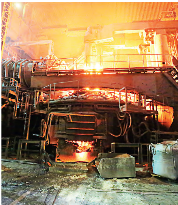
▲ Электродуговая сталеплавильная печь — большой и сложный агрегат
